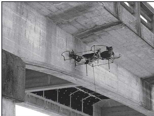
Дрон инспектирует дорожный мост путем постукивания для определения пустот и обветшаний (источник: компания NEC)
